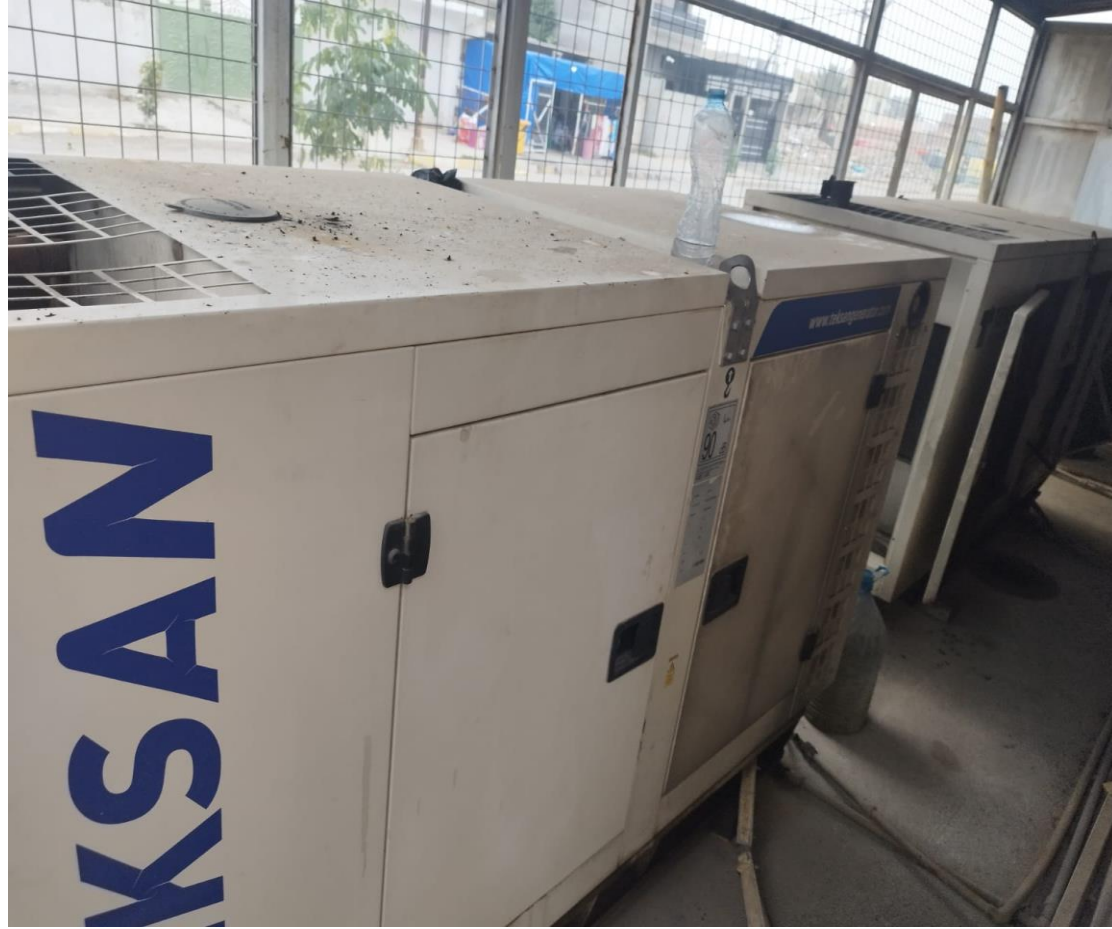
مولدة كهربائية 50 كيلو فولت أمبير - Generator 50kVa
